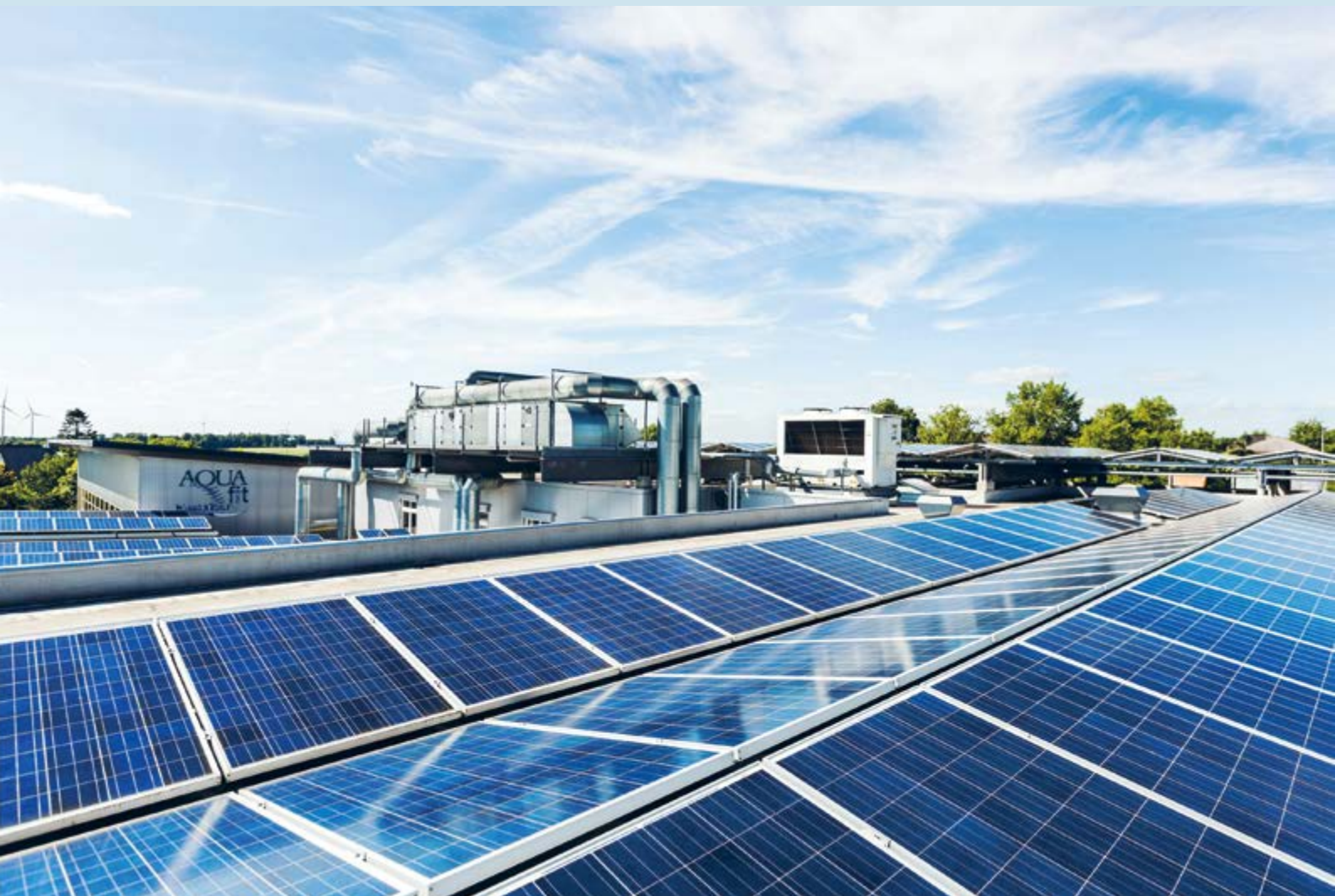
Photovoltaik auf dem Dach eines Gesundheitszentrums, zum größten Teil für die Eigenversorgung des energieintensiven Betriebes
